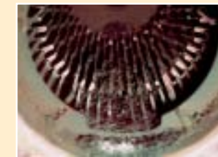
Kesselwand mit Standard-Heizöl.
