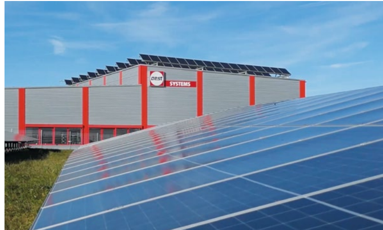
Neue Photovoltaikanlage von Oest.
